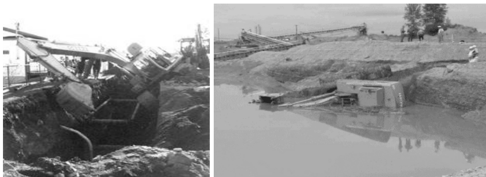
Hình 4.24. Máy xúc bị đổ vì đi sát miệng hố đào và tại nơi đất không ổn định
