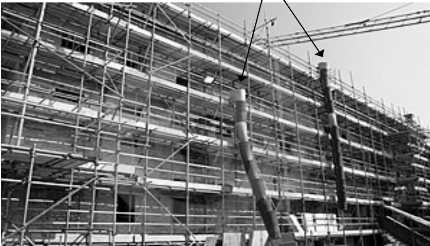
Hình 7.6. Đường ống thu rác bằng nhựa trên công trình
