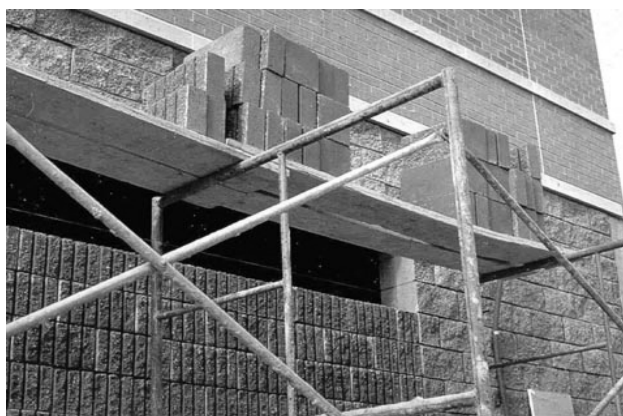
Hình 3.49. Gạch đặt trên sàn công tác mà không có ván chắn vật
