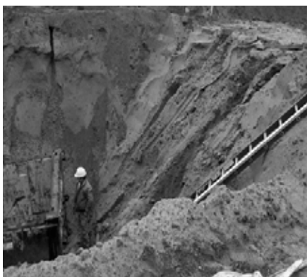
Hình 3.31. Hố đào sâu và thang lên xuống cho công nhân
