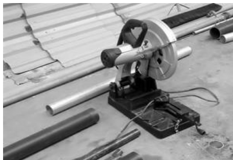
Hình 4.12. Dây điện đặt ở vị trí nguy hiểm
