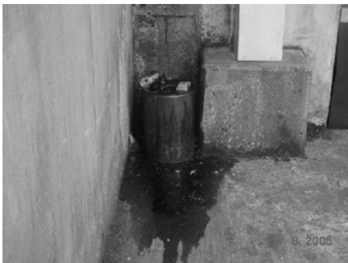
Hình 7.5. Dầu mỡ bị chảy ra bên trong công trình
