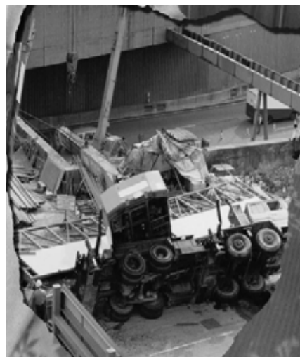
Hình 4.4. Cẩu trục bánh lốp bị lật do tải quá tải
