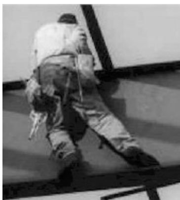
Hình 3.45. Công nhân không đeo dây an toàn khi lắp ghép kết cấu thép
