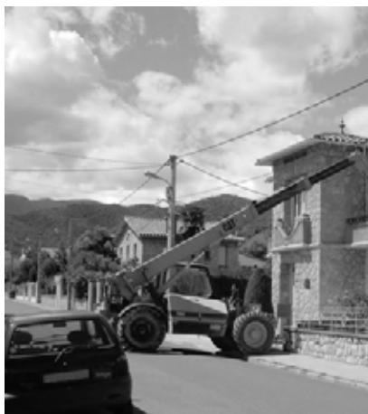
Hình 4.10. Cần trục chạm vào dây điện trong lúc làm việc
