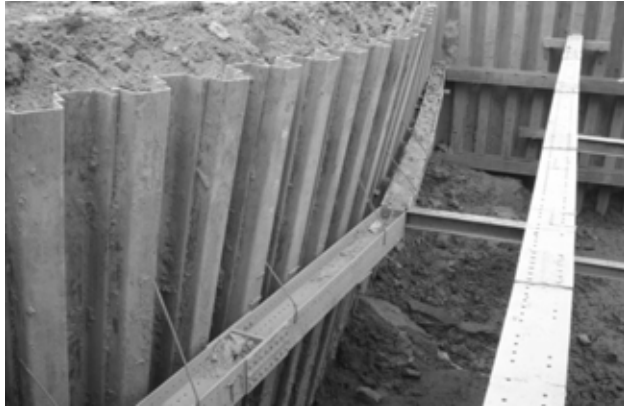
Hình 3.24. Tường vây tầng hầm đang bị sụp đổ
