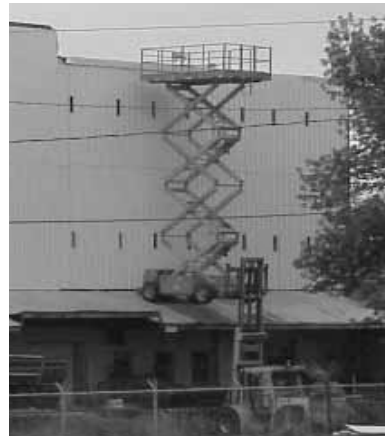
Hình 5.12. Sử dụng thang nôi máy không đúng yêu cầu về an toàn
