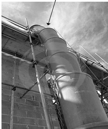
Hình 7.7. Hình ảnh chụp gần ống thu rác bằng nhựa trên công trình
