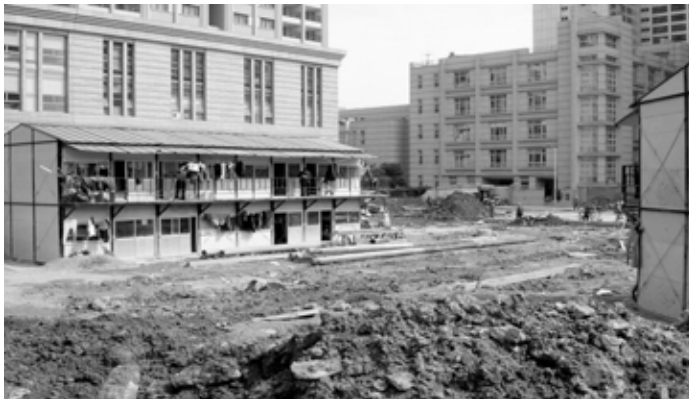
Hình 7.1. Công trường có nhiều đất bừa bấn
