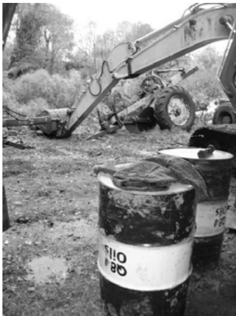
Hình 7.4. Dầu mỡ của các máy xây dựng bị đổ trên nền đất công trường
