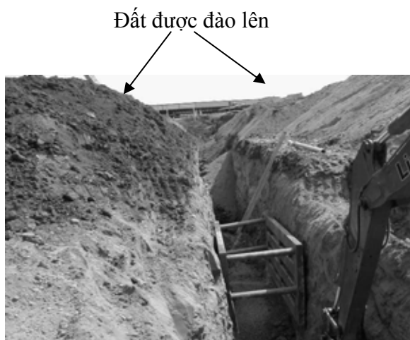
Hình 3.27. Đất đổ quá sát mép hố đào
