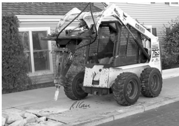
Hình 3.5. Máy phá bê tông thiếu các thiết bị che chắn cho người điều khiển
