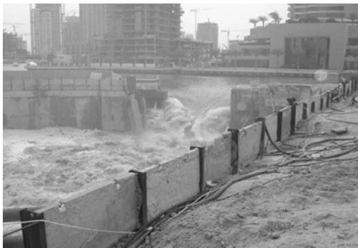
b) Tường vây bị vỡ và nước tràn vào trong
