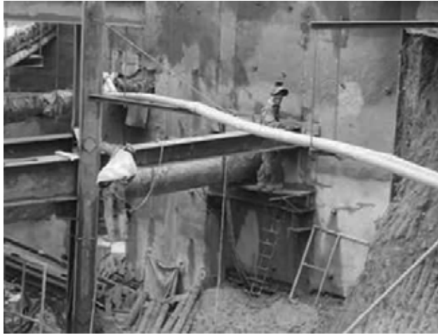
Hình 3.26. Công nhân leo trèo nguy hiểm
