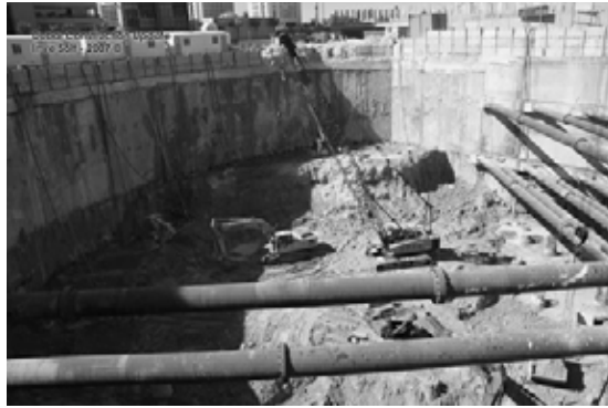
a) Cảnh tầng hầm đang thi công trước khi bị tai nạn
